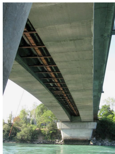
Tablier vu de dessous (depuis la rive droite) Phot. I. Havard IVR82_20106907011NUCA
