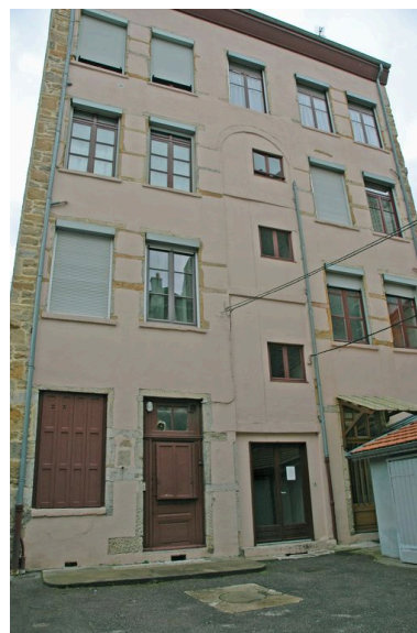
Façade ouest côté cour vue depuis le sud Phot. Maryannick Chalabi IVR82_20066901393NUCA
