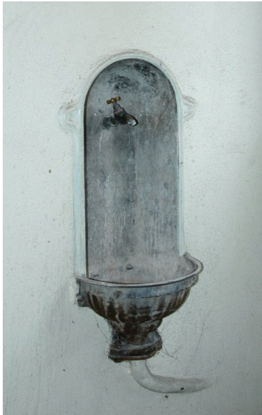
Fontaine située sur le mur sud du repos de chaque palier Phot. Maryannick Chalabi IVR82_20066901300NUCA
