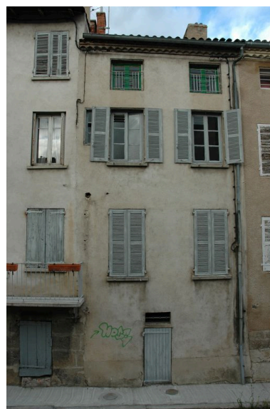
Elévation postérieure donnant sur le quai du Vizézy. Phot. Simone Hartmann-Nussbaum IVR82_20134200527NUCA
