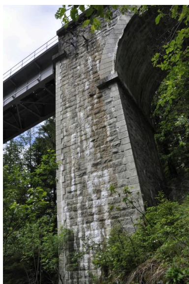
Une pile-culée disposant d'un sommier sur lequel est posé le tablier métallique Phot. Samir Mahfoudi IVR84_20207401188NUCA
