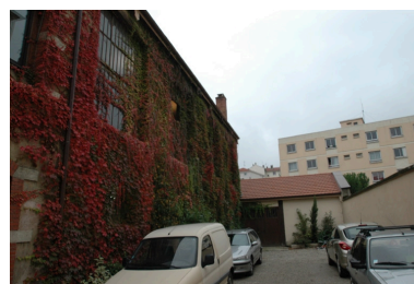
Baies atelier à bras (1er étage), vue nord-ouest Phot. Nadine Halitim-Dubois IVR82_20096901609NUCA
