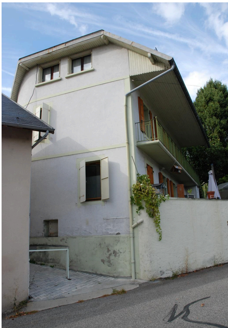
Maison, rue Jean-Louis Bouvet (la Montaz, 2018 E1 849). Au niveau du soubassement, répartiteur du captage dit "Eau des 6e".
