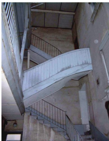
Vue d'ensemble de l'escalier desservant le 2 et le 4 rue Seguin Phot. Bernard Ducouret IVR82_20006900538NUCA
