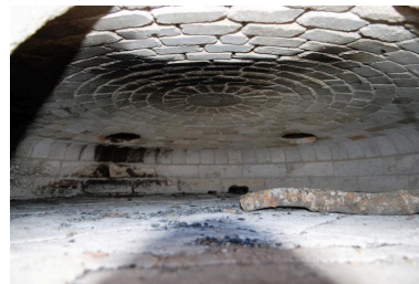
Détail de la voûte du four à pain Phot. Thierry Monnet IVR84_20187410829NUCA
