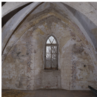
Bas-côté sud, baie de la 2e travée : détail du décor peint. Phot. Jean-Marie Refflé IVR82_20004200530XA
