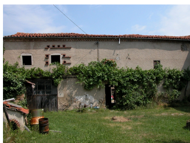
Vue de l'élévation sud du logis du fermier et de la remise-atelier (à l'étage, ouvertures du pigeonnier). Phot. Thierry Monnet IVR82_20134200862NUCA
