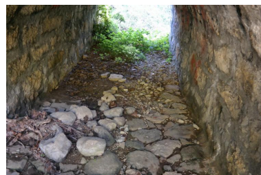
Pont du Borgel, vue du lit du cours d'eau sous le pont Phot. Pascale Renard IVR84_20207401509NUCA
