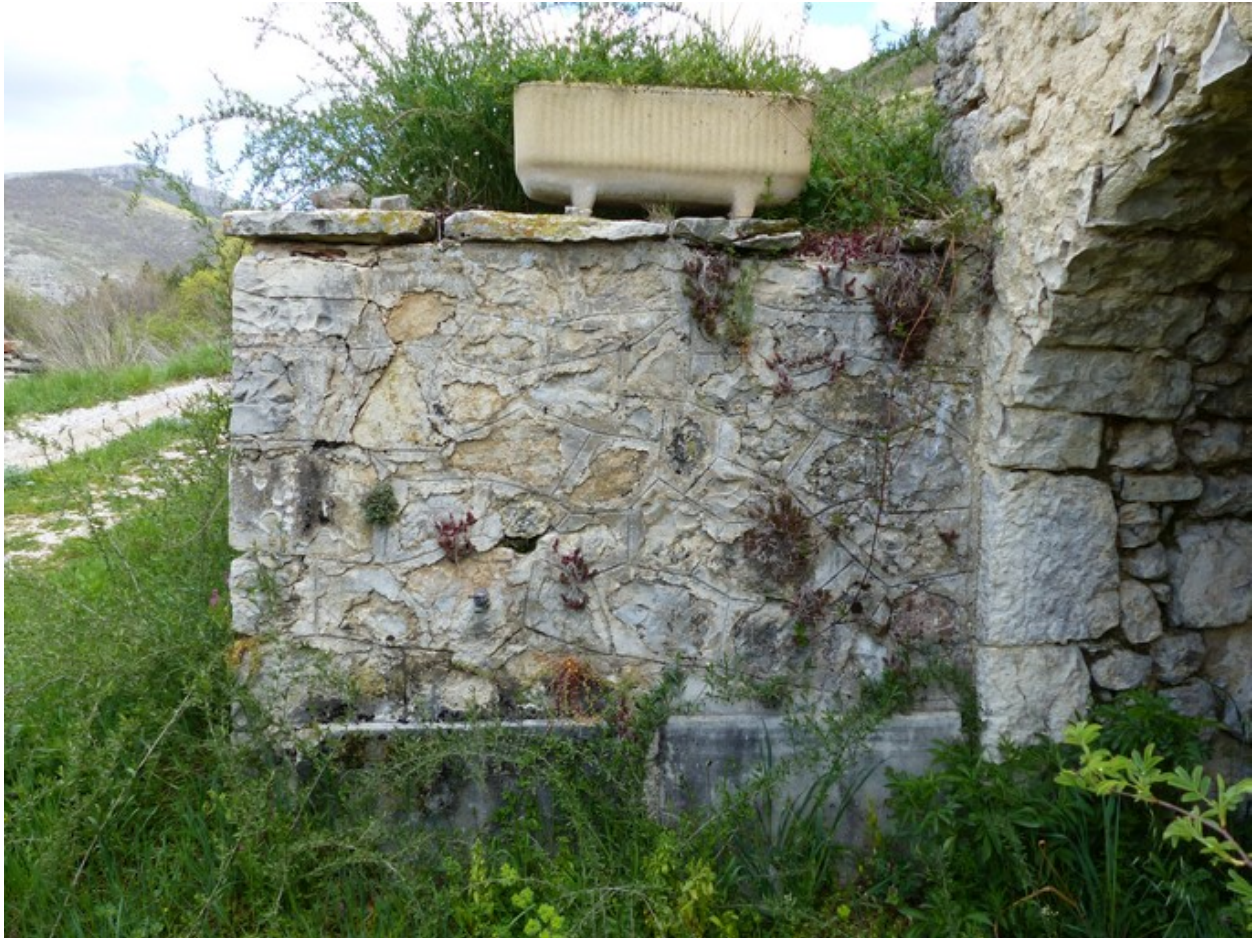
Bâtiment du réservoir. Elévation sud, et arrachement du lavoir en béton.
