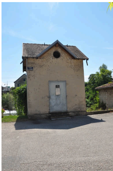
Vue du transformateur Phot. Yannick Milleret IVR82_20107300545NUCA
