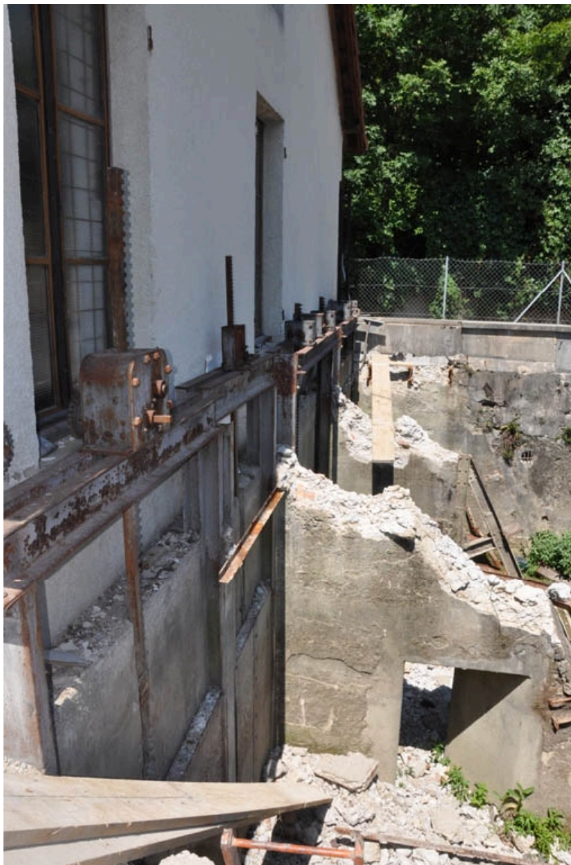
Vue de la façade est de la centrale avec le système de vannage
