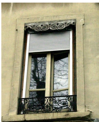
Détail d'une fenêtre, de son balconnet et de son lambrequin Phot. Maryannick Chalabi IVR82_20016900135NUCA
