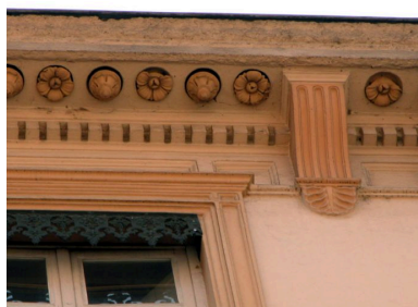
Bâtiment 1, façade sur rue, détail de la corniche Phot. Bernard Ducouret IVR82_20046900660NUCA
