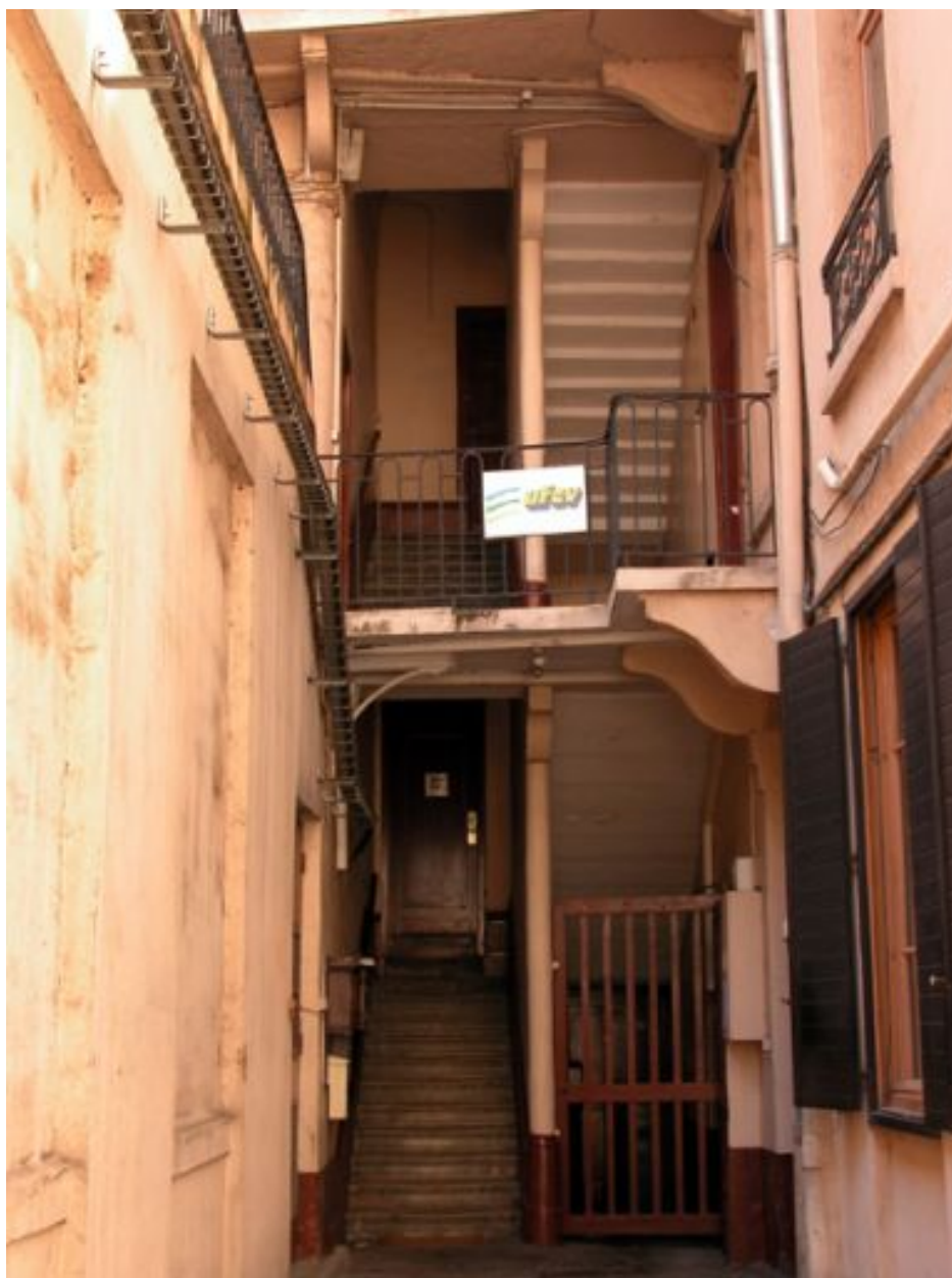
Bâtiment 3 vu depuis la cour III, élévation des 2 premiers niveaux de la cage d'escalier
