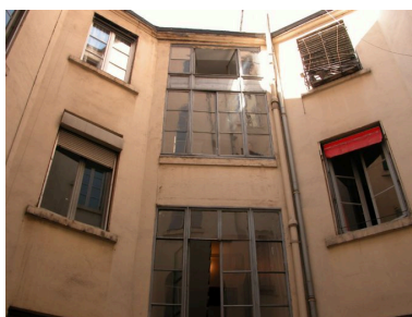
Bâtiment 2, élévation sur la cour I, partie supérieure Phot. Phot. Inv. D. Chevallier IVR82_20046900662NUCA
