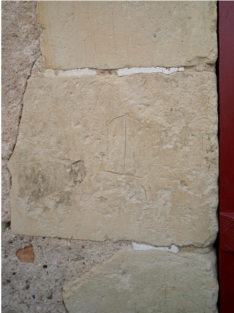
Graffitis sur les piédroits d'une baie du bâtiment sud : lettres : MBC, ancres de marine.
