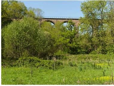
Vue générale du viaduc du Soleil depuis la vallée qu'il enjambe. Phot. Jean-Michel Périn IVR83_20150300044NUC4A
