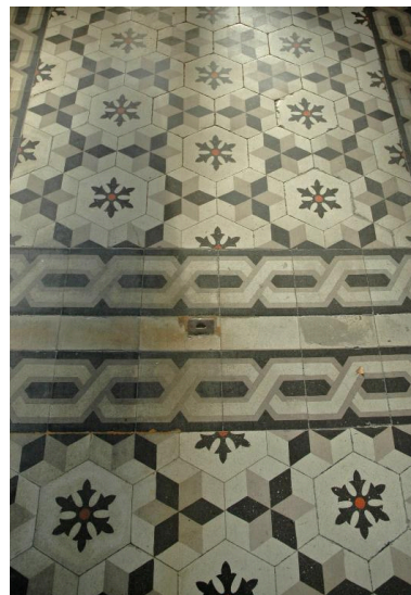
Vue intérieure du bâtiment sur quai : détail du pavement Phot. Magali Delavenne IVR82_20146902808NUCA
