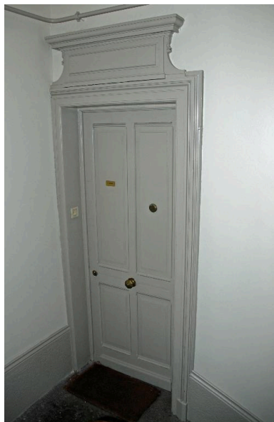
Vue intérieure : une porte palière au deuxième étage Phot. Magali Delavenne IVR82_20156901186NUCA
