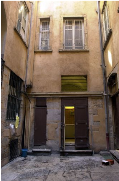
Aile gauche, partie inférieure de la façade sur cour Phot. Bernard Ducouret IVR82_20036901331NUCA
