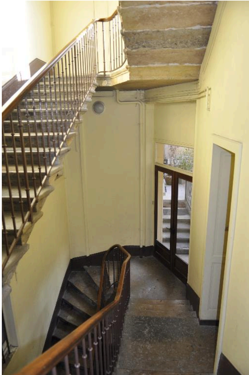
Vue intérieure de l'immeuble : la première révolution d'escalier et les porte desservant la maison en fond de cour (au fond) et la maison sur la rue Pasteur (à droite)
