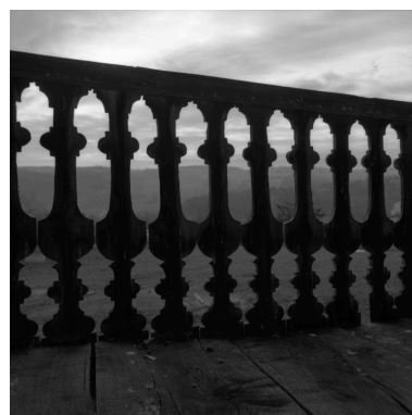
Façade antérieure, détail de la galerie (vue de l'intérieur, vers l'église). Phot. Eric Dessert IVR82_20014201328X
