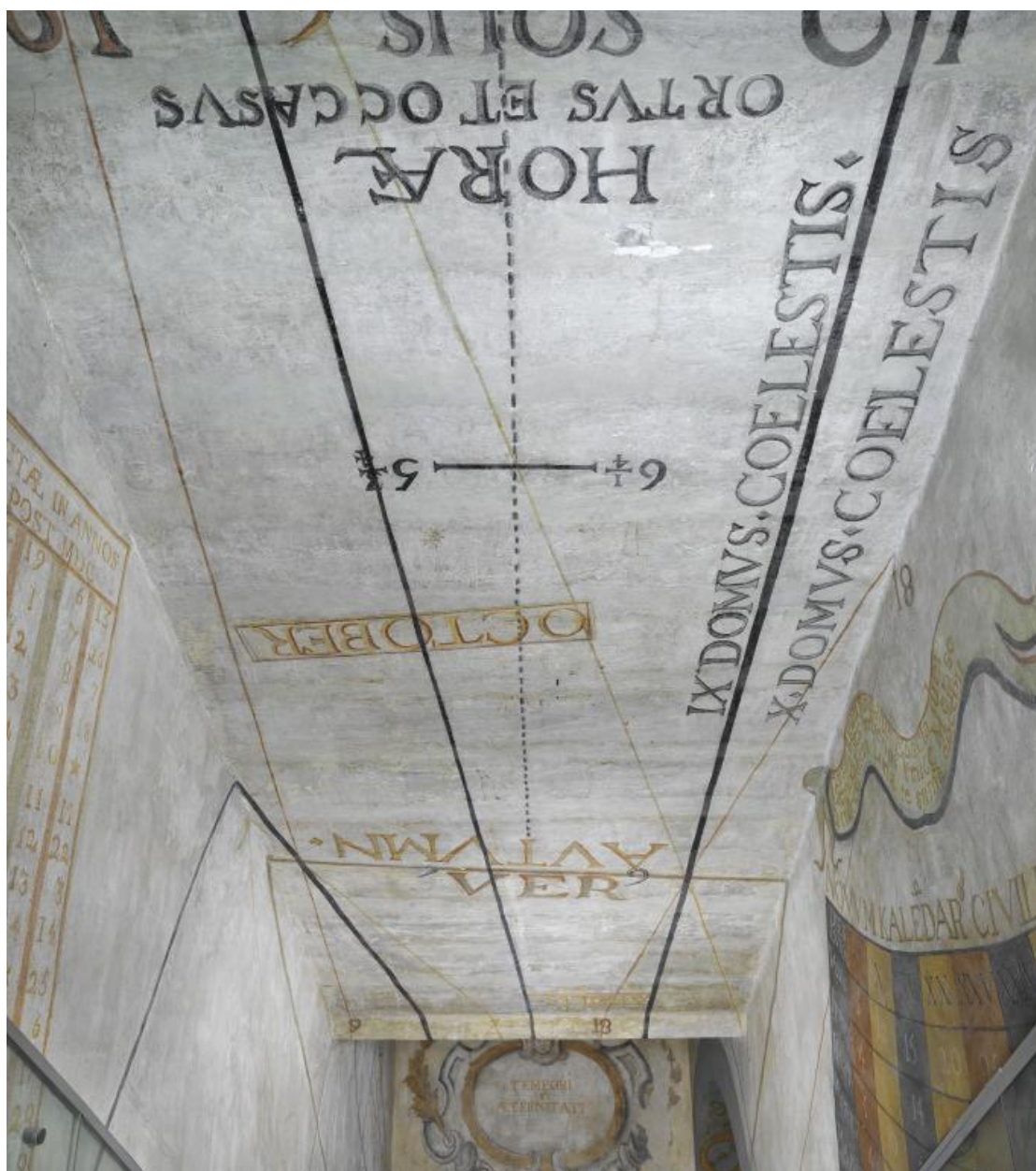
Plafond de la première volée de l'escalier
