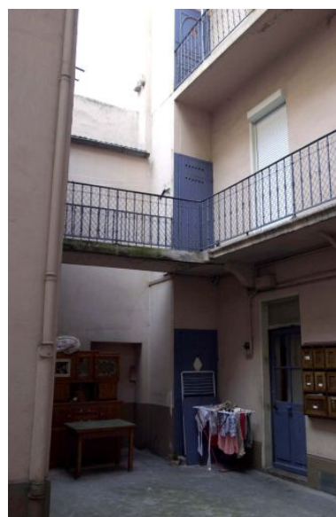
Vue des coursières et de la passerelle vers l'immeuble sur cour Phot. François Blanchetière IVR82_20016902316NUCA
