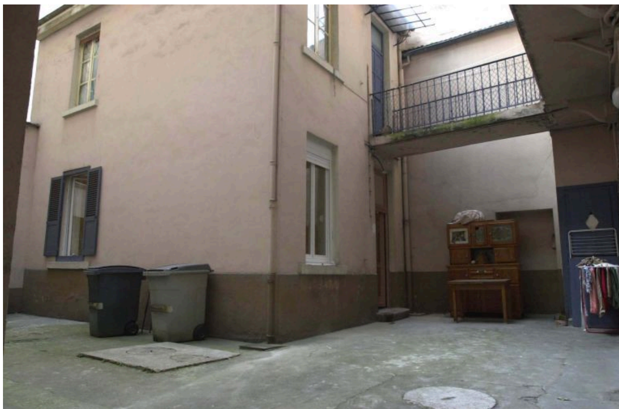
Vue de l'immeuble sur cour et de la coursière du 1er étage
