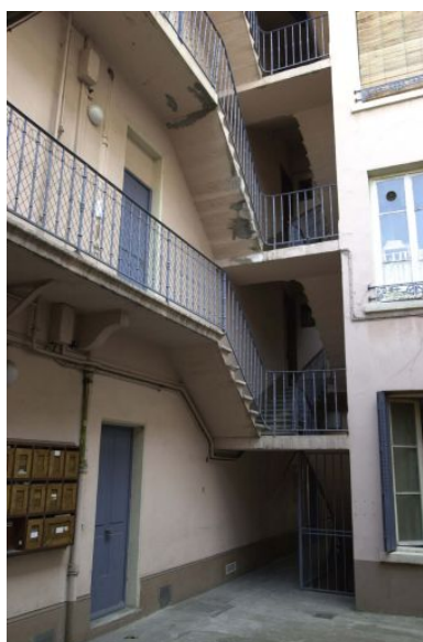
Vue de la cage ouverte de l'escalier et des accès aux coursières Phot. François Blanchetière IVR82_20016902317NUCA
