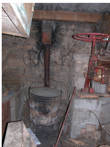
Vue intérieure de la chaudière. Phot. Thierry Monnet IVR82_20114202285NUCA
