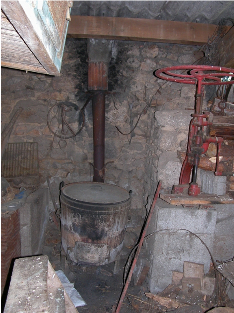
Vue intérieure de la chaudière.
