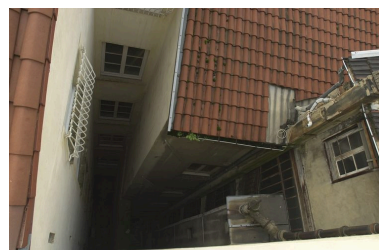
A droite, la cour depuis l'escalier de l'immeuble sis 10 rue de l'Ancienne-Préfecture Phot. Véronique Belle IVR82_20076901206NUCA
