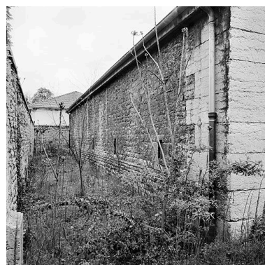
Vue de l'espace entre le mur et la chemise Phot. Didier Gourbin IVR82_20046904288X
