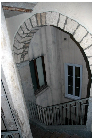
La cour depuis la cage d'escalier : arc en plein cintre Phot. Véronique Belle IVR82_20066902545NUCA
