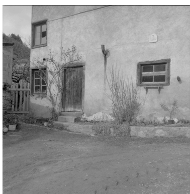
Partie gauche de l'élévation des communs : encadrement de baie inséré horizontalement dans la maçonnerie de pisé. Phot. Eric Dessert IVR82_20024200735X
