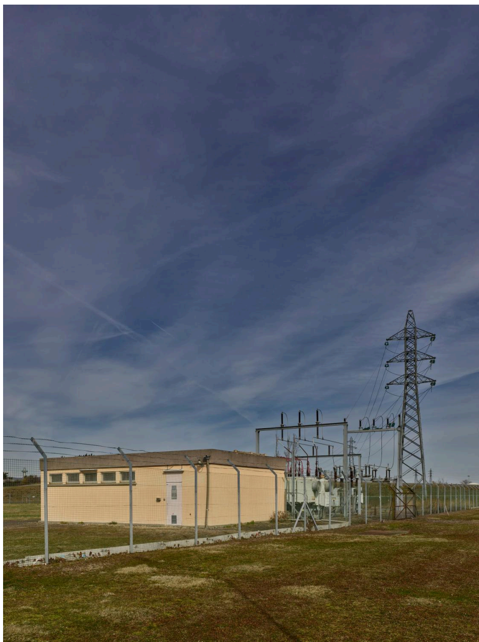
La station électrique, au nord-ouest du site.
