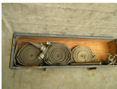
Vue du placard avec le matériel incendie. Phot. Clémence Serve IVR82_20117403512NUCA
