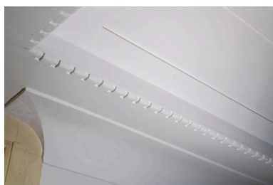
Troisième étage, cage d'escalier nord, plafond : détail de la corniche moulurée Phot. Michel Pérès IVR84_20216900180NUCA
