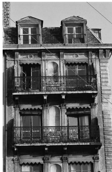
Façade sur le quai, détail des niveaux 5 et 6 et des lucarnes du comble Phot. Jean-Marie Refflé IVR82_19796900061Z
