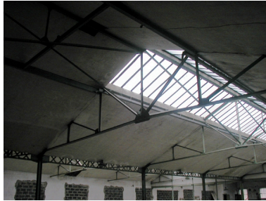
Détail lanterneau Phot. Catherine Bouffière IVR82_20036901964NUCA
