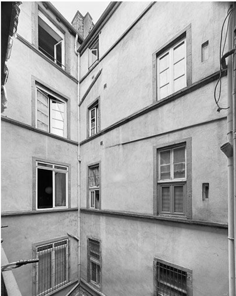
Cour, à gauche revers du bâtiment sur rue, à droite élévation du corps de liaison
