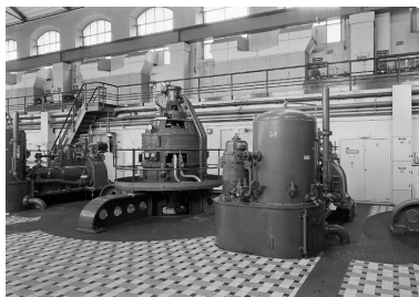
Turbine G2, le matériel Electrique S. W. Phot. Eric Dessert IVR82_20026904359P
