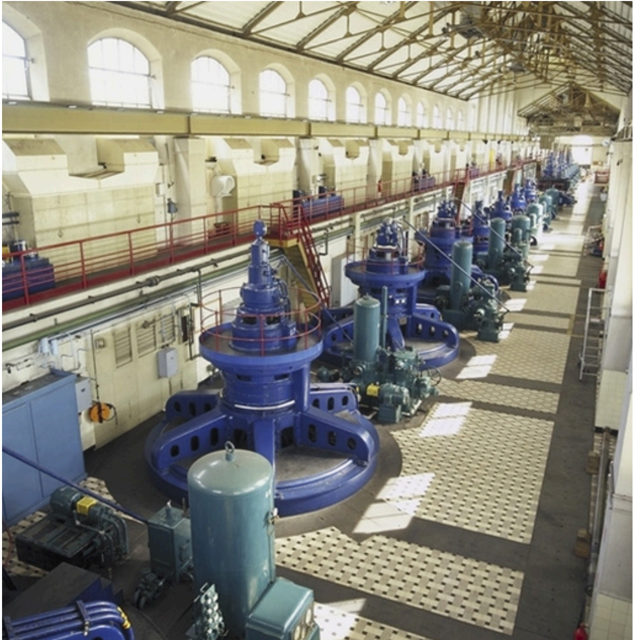
Salle des machines vue sud
