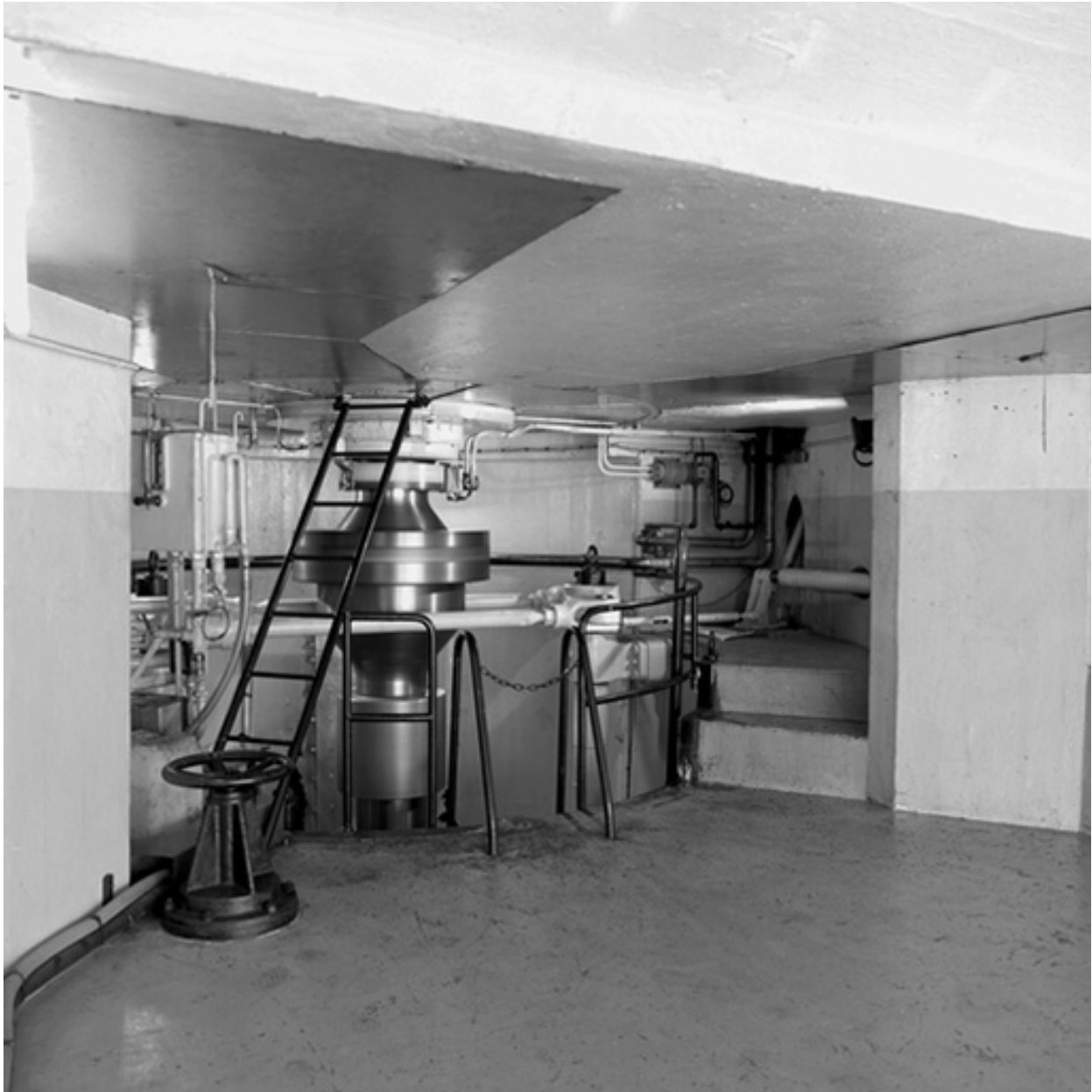
Partie de turbine en sous-sol
