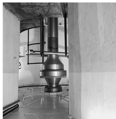
Partie inférieure de turbine au sous-sol Phot. Eric Dessert IVR82_20026904363X
