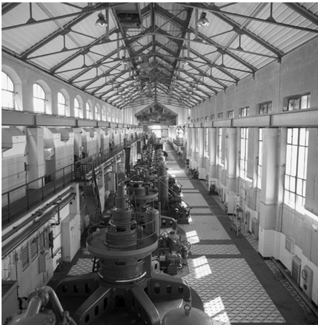
Vue d'ensemble salle des machines
