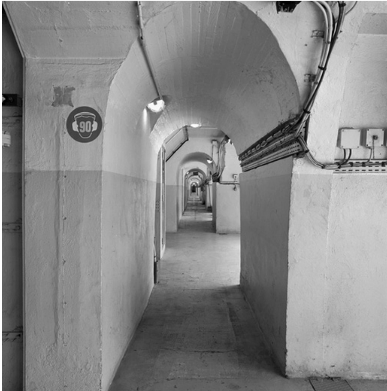
Galerie des turbines en sous-sol
