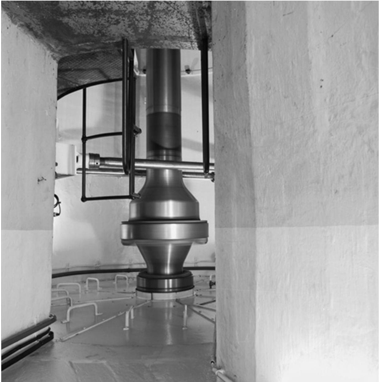
Partie inférieure de turbine au sous-sol
