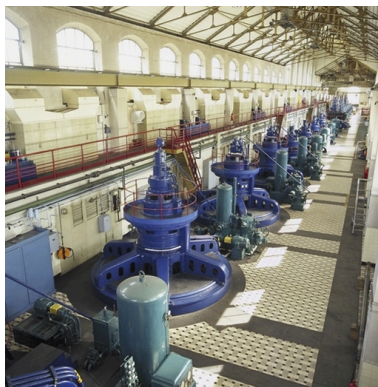
Salle des machines vue sud Phot. Eric Dessert IVR82_20026904350XA
