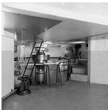
Partie de turbine en sous-sol Phot. Eric Dessert IVR82_20026904362X
