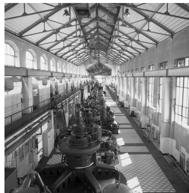
Vue d'ensemble sud de la salle des machines Phot. Eric Dessert IVR82_20026904351XA
