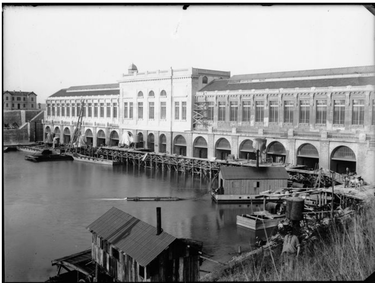
[Construction de la centrale de Cusset. Canal de Jonage et centrale hydroélectrique de Cusset]. 1897-1908. 1 fotogr. : plaque de verre, n. et b. (AD Rhône. 156 J 398, n°141)
