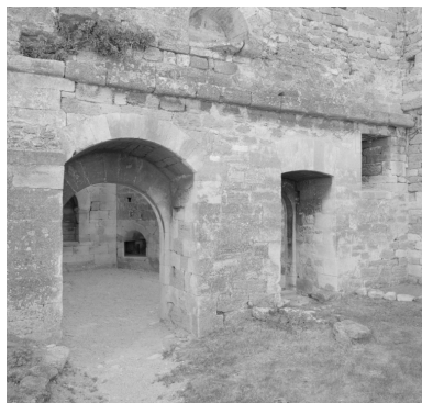
Bâtiment nord, intérieur du mur sud, parties basses. Phot. Alain Franchella IVR82_19992600266X
