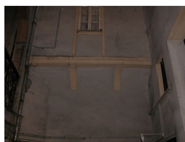
1ère cour, galeries de liaison à gauche, voûte en demi- berceau portant le 1er étage Phot. Bernard Ducouret IVR82_20046900596NUCA
