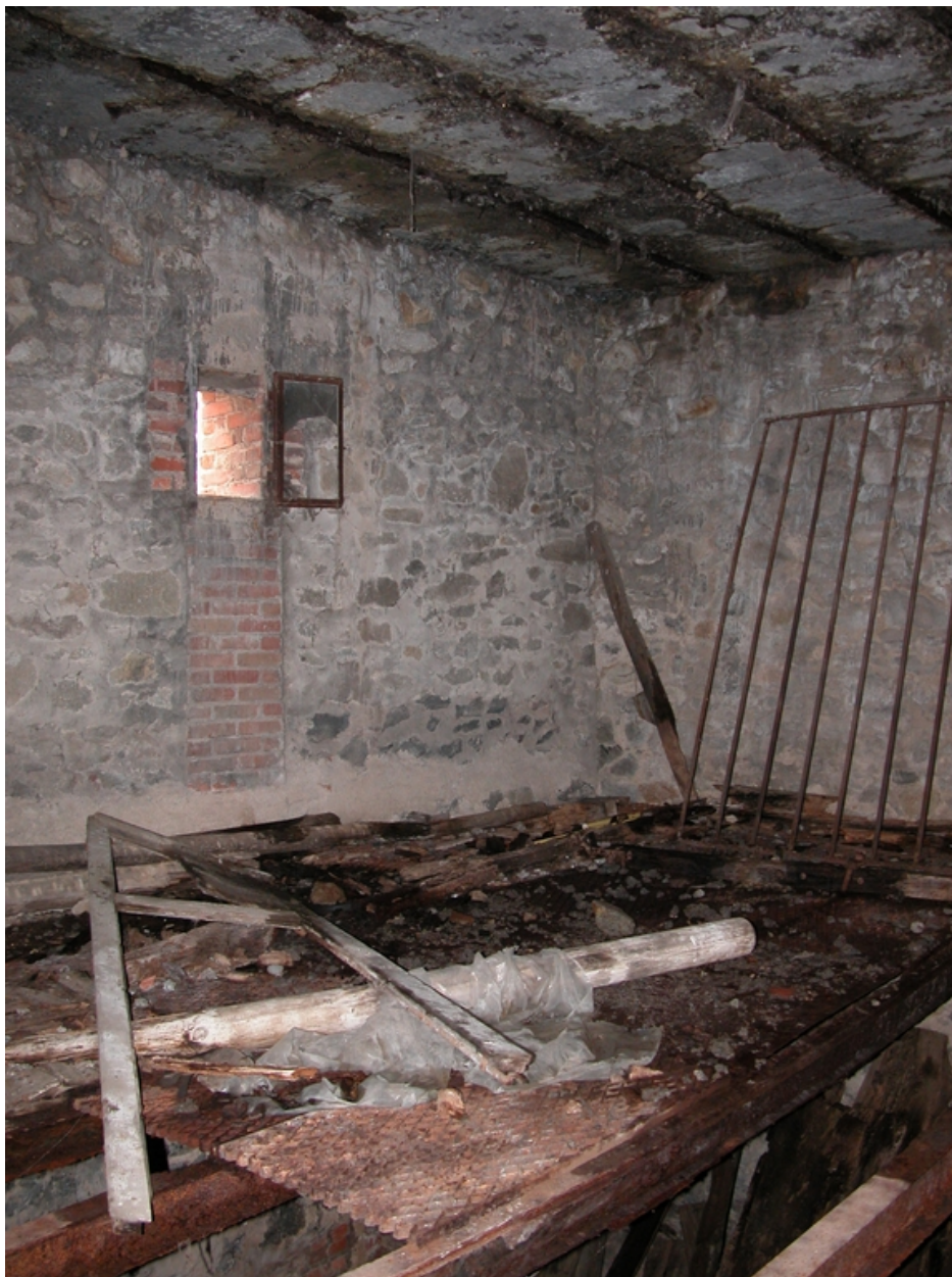
Vue intérieure du four, niveau haut.
