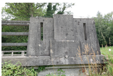
Pont Borian, détail du garde-corps avec borne géodésique Phot. Pascale Renard IVR84_20207403129NUCA
