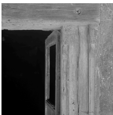
Logis ancien, vue de détail de la baie à encadrement mouluré de la cuisine du premier étage. Phot. Jean-Marie Refflé IVR82_20024201011X
