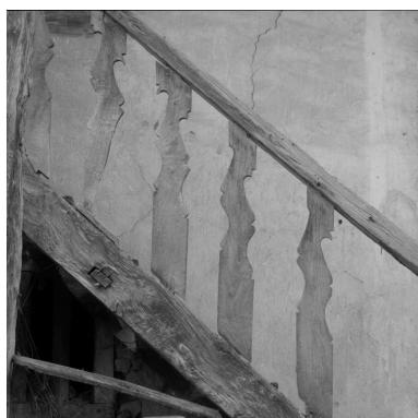
Logis ancien, vue de détail de la main courante de l'escalier. Phot. Jean-Marie Refflé IVR82_20024201013X
