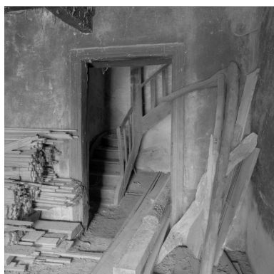
Second logis, départ de l'escalier desservant le premier étage. Phot. Eric Dessert IVR82_20024201023X
