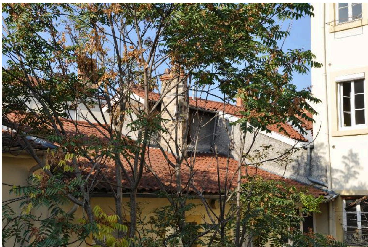
Vue de toiture : petit massif articulant l'escalier du 15 rue Reinach et les combles du 49 rue Pasteur
