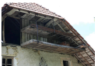
Vue du mur pignon est : détail des claies de séchage. Phot. Thierry Monnet IVR84_20207400644NUCA
