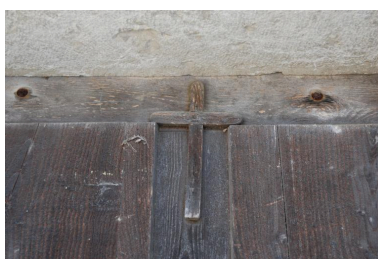
Détail des ouvertures de l'habitation est : croix clouée sur la porte. Phot. Caroline Guibaud IVR84_20207400652NUCA
