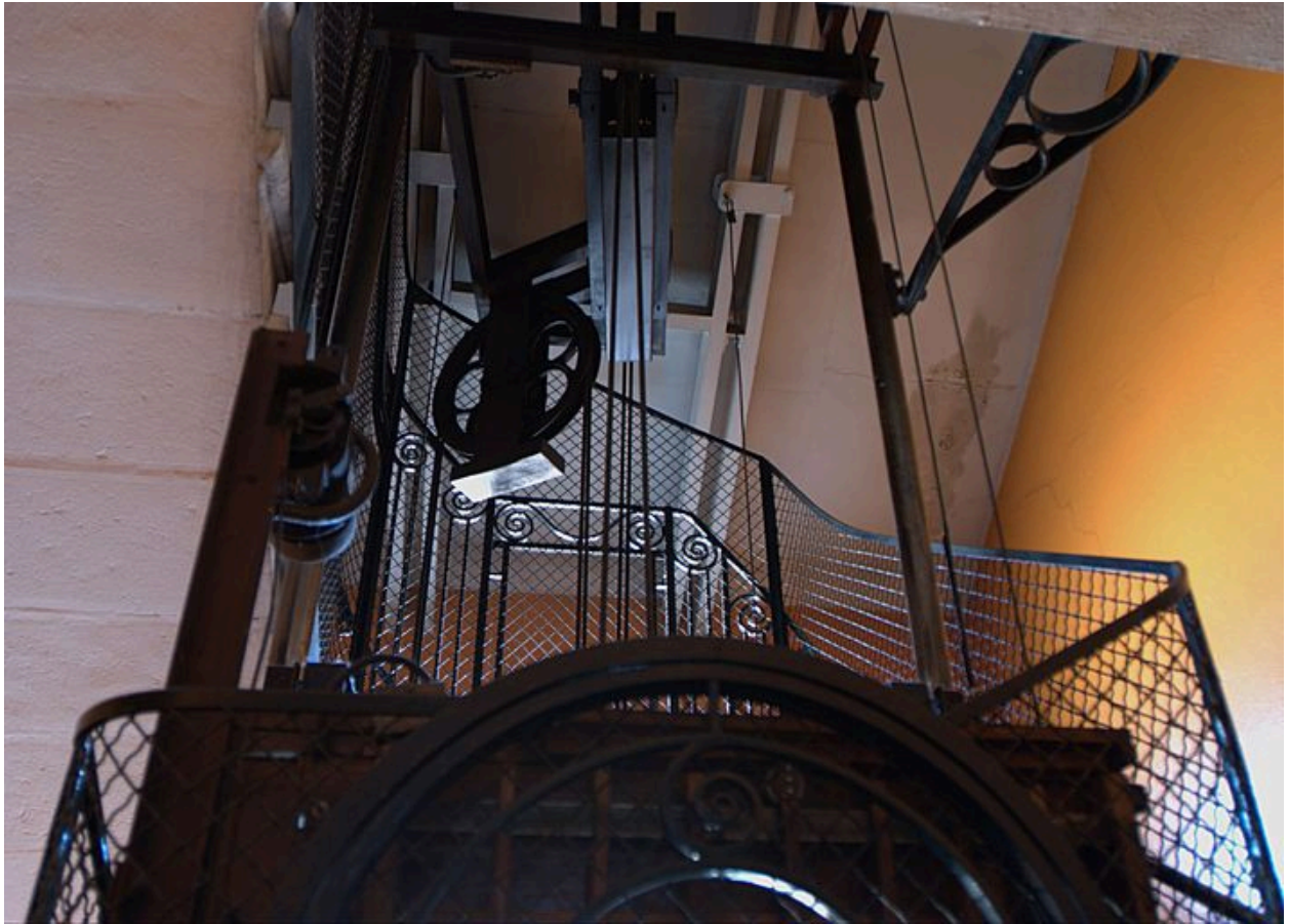
Ascenseur, détail du mécanisme
