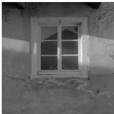
Logis à aître, élévation latérale droite, détail de la baie du rez-de-chaussée. Phot. Eric Dessert IVR82_20034200202X
