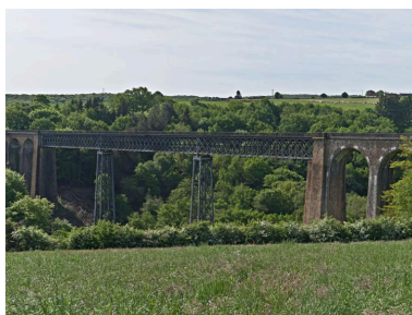
Vue de la partie centrale, à structure métallique, du viaduc. Phot. Jean-Michel Périn IVR83_20150300052NUC4A
