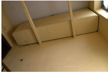
Vue de la citerne en tôle au dernier étage Phot. Maryannick Chalabi IVR82_20016900257NUCA
