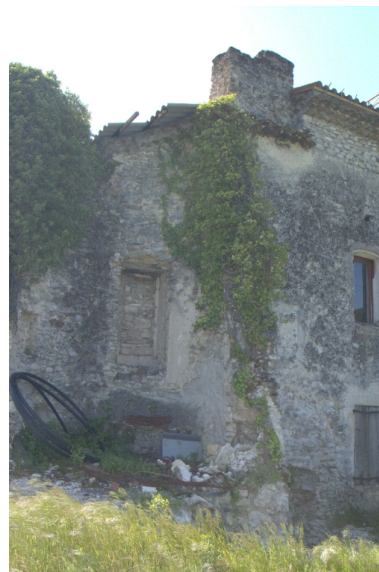
Détail de l'élévation nord, tour effondrée sur l'angle nord-est. Phot. Geneviève Jourdan IVR82_20102600543NUCA
