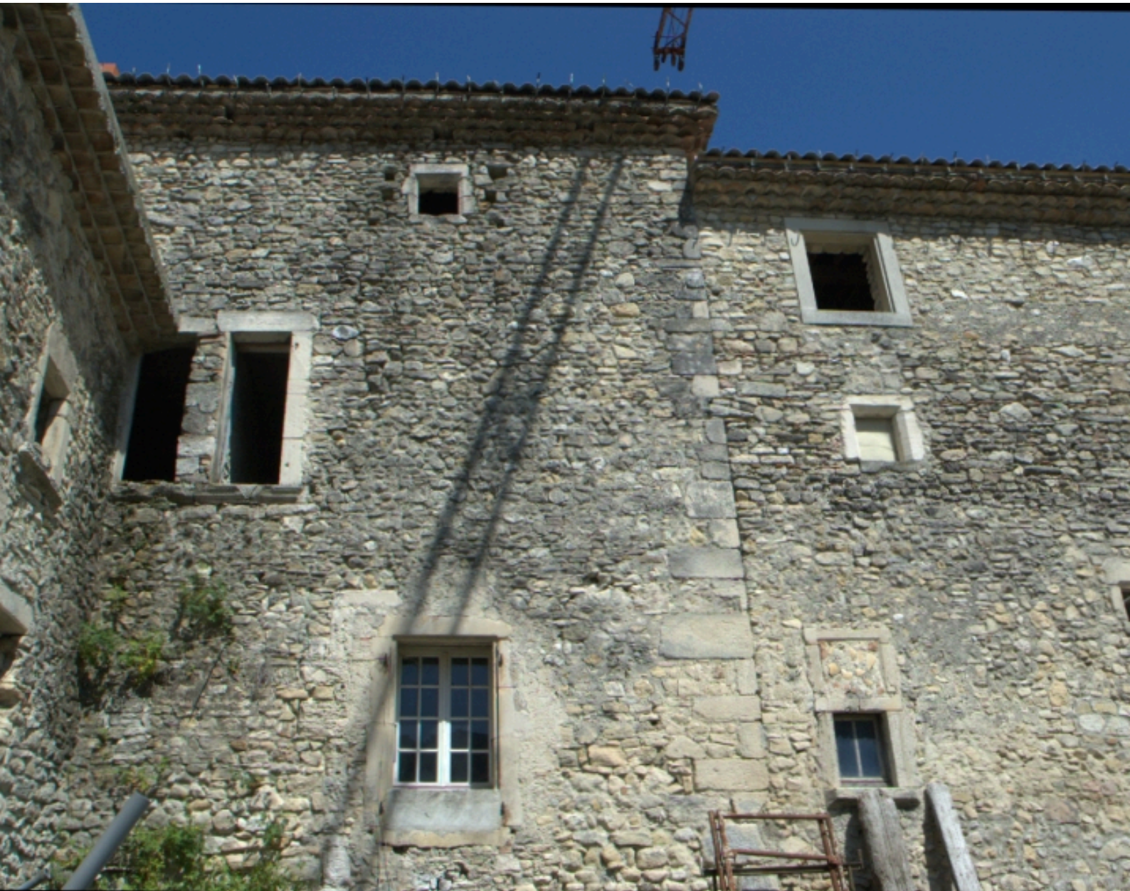
Vue partielle de la façade sur cour, côté gauche, montrant la reprise de construction.
