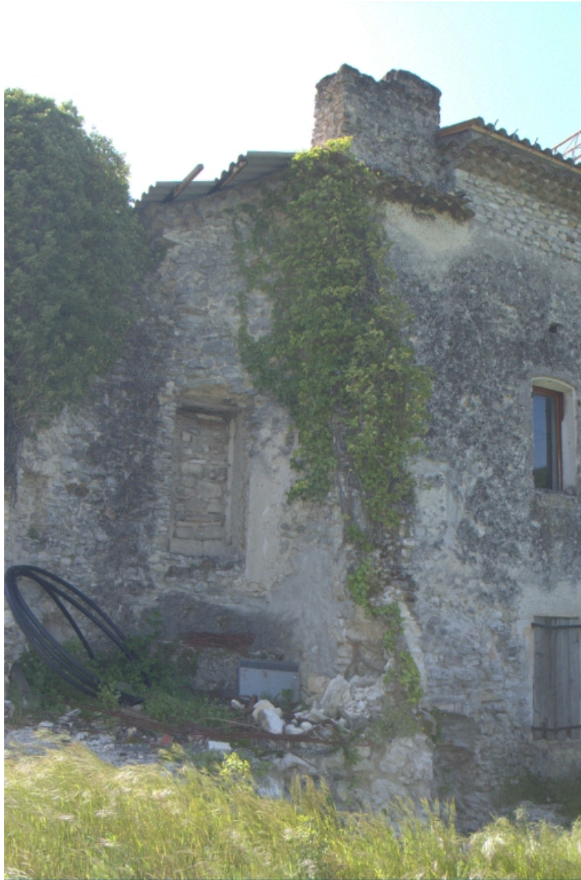
Détail de l'élévation nord, tour effondrée sur l'angle nord-est.
