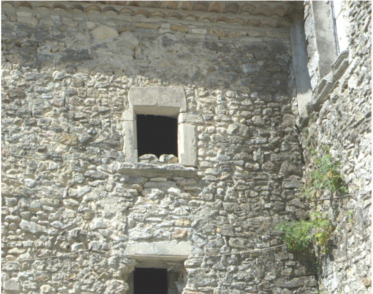
Aile gauche sur cour, 2e niveau, détail : fenêtre à piédroits chanfreinés et à linteau chargé d'une accolade .
