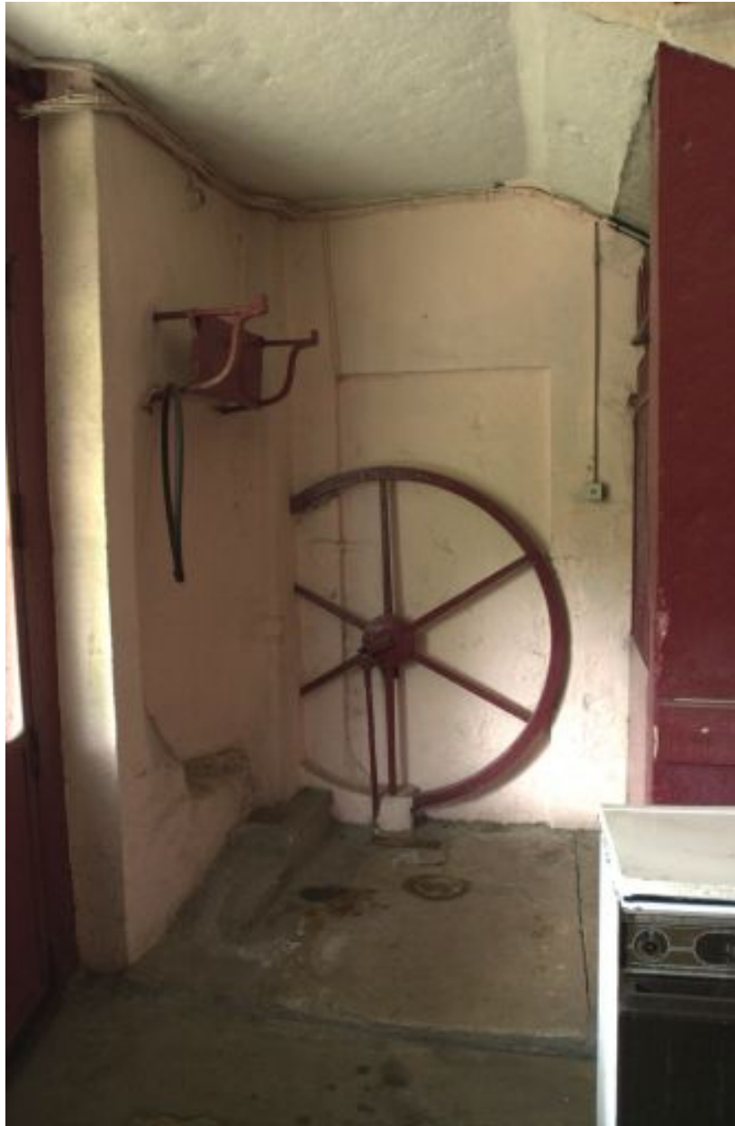
Vue de la pompe à l'arrière de l'escalier
