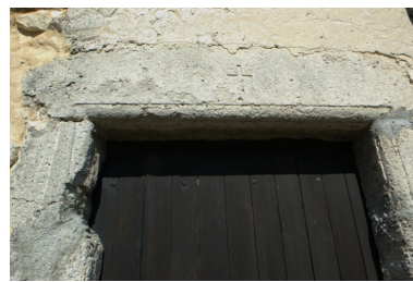
Détail de la porte d'entrée dans l'élévation latérale gauche : linteau gravé d'une croix. Phot. Geneviève Jourdan IVR82_20102600529NUCA
